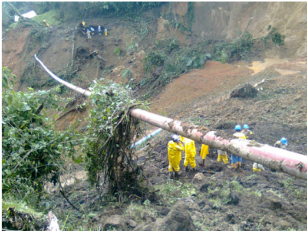
Figura 3. Tubería expuesta a causa de movimiento telúrico. Fuente: («CNO-Gas», s. f.)
